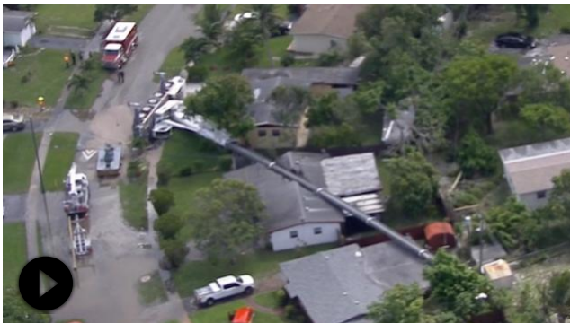
Hijskraan valt bovenop twee huizen in Florida
